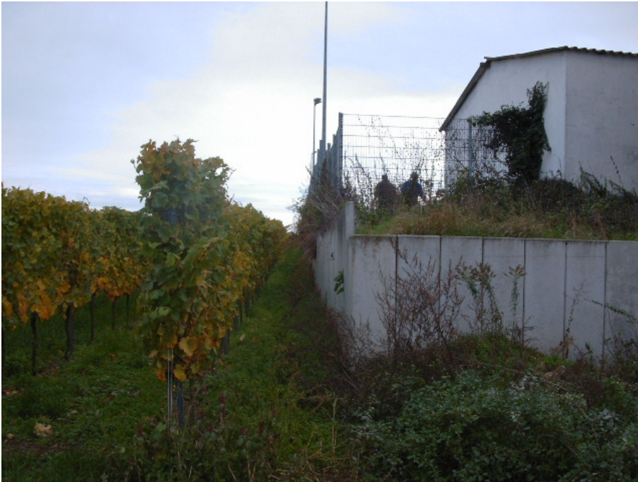
Bild 3: von Nord nach entlang der östlichen Grundstücksgrenze mit Blick auf die Stützmauer
